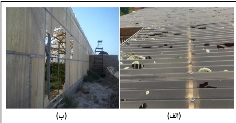
شکل ۱۶- پوشش پلی‌کربناتی آسیب‌دیده از بارش تگرگ (الف) و وزش باد شدید (ب)
